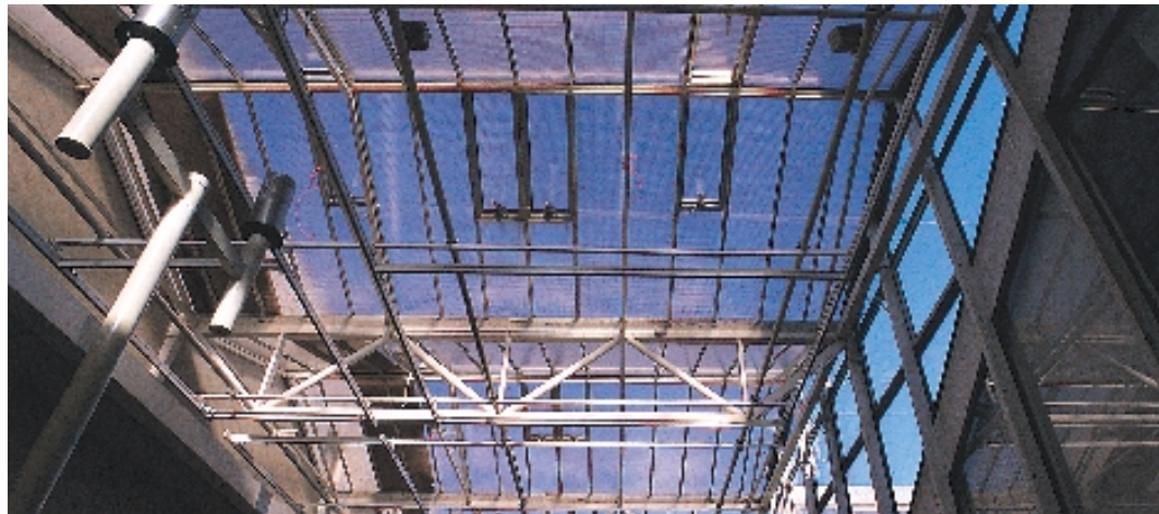
La Communauté d'agglomération a consacré plus de deux millions de francs au traitement solaire du CAC.
