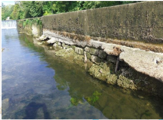
Détail des dégradations de la chaussée
