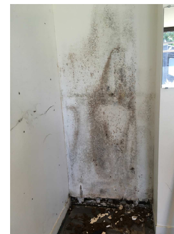
Fuite mur Accueil Découverte 25 juillet 2022
